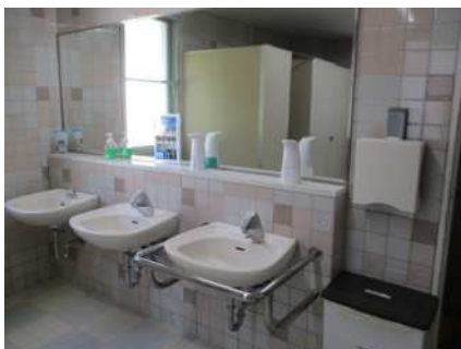
出入口に ペーパータオル・消毒液を設置
